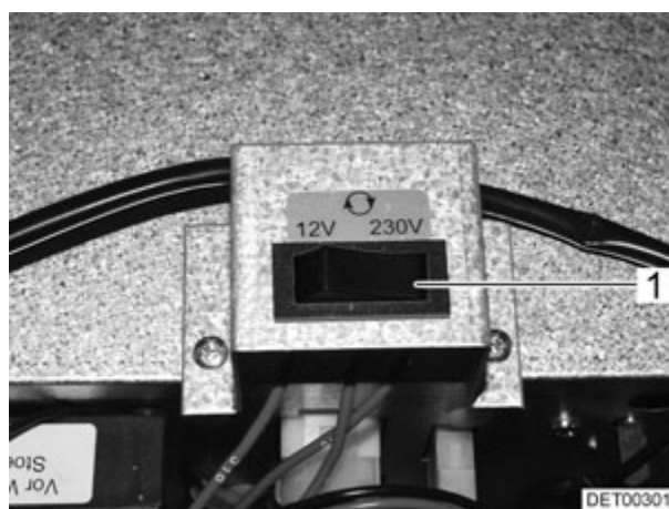
Fig. 131 Conmutador bombas de circulación
