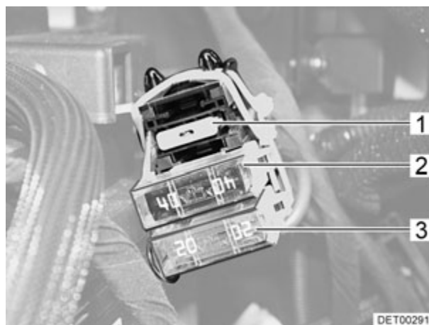
Fig. 118 Fusibles en la batería del motor de arranque
