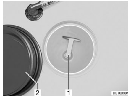
Fig. 141 Tapa de cierre del tubo de llenado de agua potable
